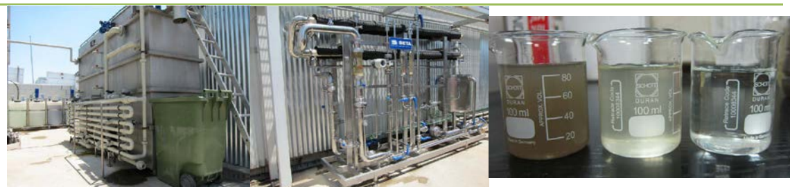
EDAR : Calidad obtenida CAF (izquierda), Ultrafiltración (centro) y calidad (derecha)
